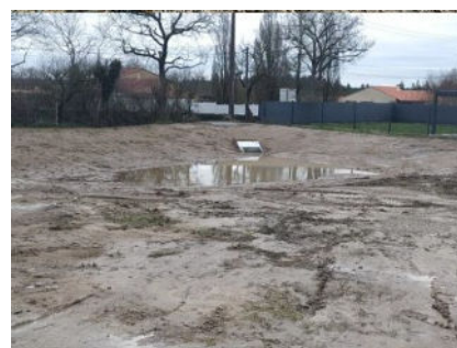
Nouveau bassin de rétention
